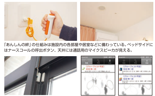
「あんしんの絆」の仕組みは施設内の各部屋や居室などに備わっている。ベッドサイドにはナースコールの呼出ボタン、天井には通話用のマイクスピーカが見える。窓や扉などのサッシには「開閉センサー」が設置。ほかにも「離床センサー」や「人感センサー」などがあり、入居者の出入りに応じてスマートフォンに通知が来る仕組み。
